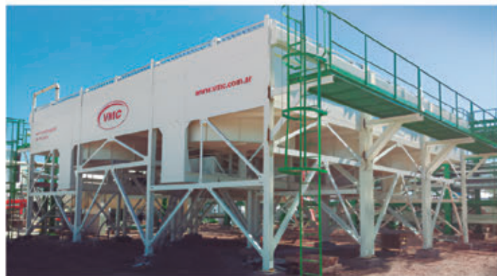
Aerofriador en planta de propano.
